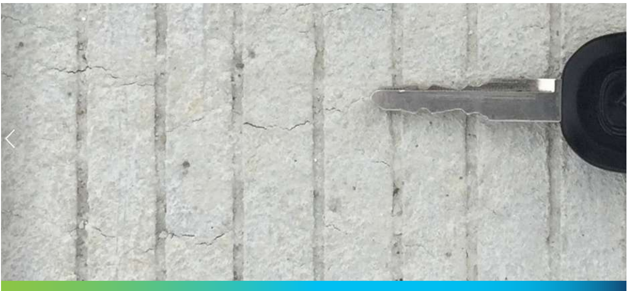
Foto 3. Concreto endurecido. Fisuras estéticas sin implicación estructural, demuestran que existió un proceso de curado deficiente.
