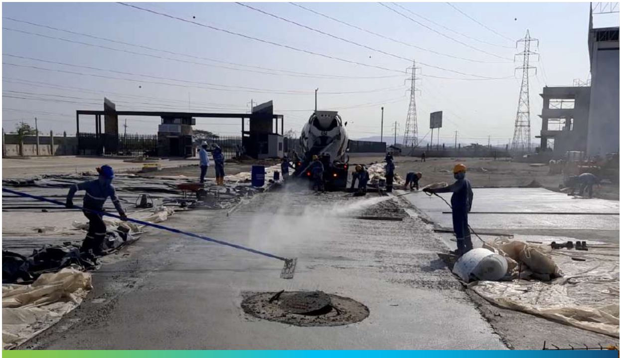
Foto 7. Rayos solares calentando la superficie del concreto, favorece el desecamiento. El riesgo de fisuración se elimina aplicando el procedimiento de curado normalizado con niebla de agua y posteriormente cubriendo el pavimento con láminas de plástico.
