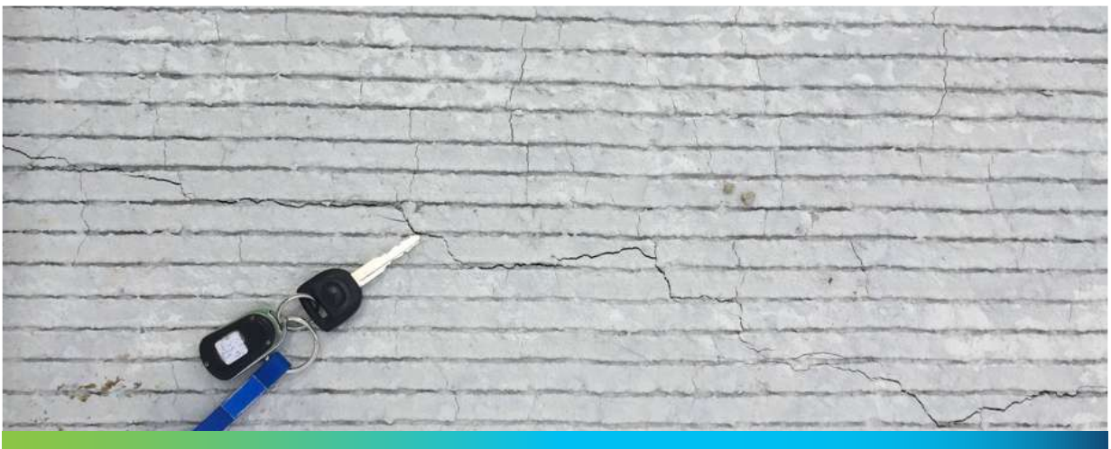
Foto 4. Concreto endurecido. La falta de curado sumado a condiciones agresivas ambientales que causan desecamiento durante el hormigonado, producen muchas fisuras en el pavimento.
