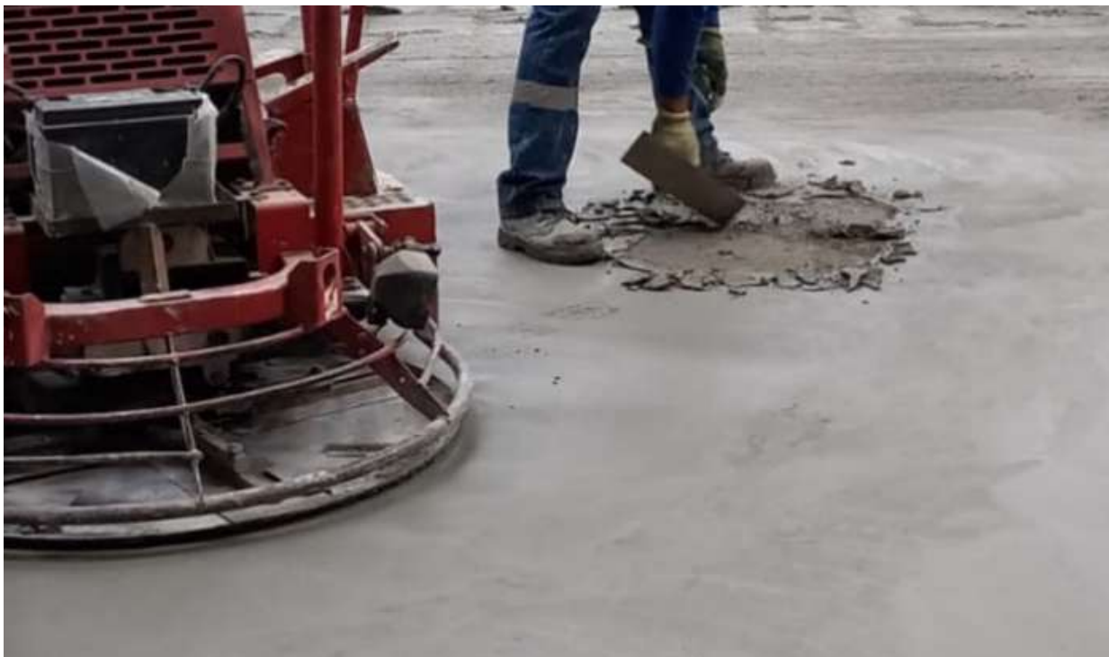
Foto 1. Hormigón fresco. Peladura en el pavimento durante el proceso de alisado mecánico causado por el desecamiento superficial del concreto.
