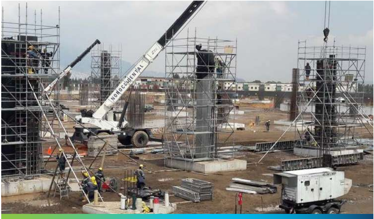
Foto 8. Metro de Quito. Estación Quitumbe. Curado de columnas empleando grúas de 20 tn y andamios para forrarlas con plástico.
