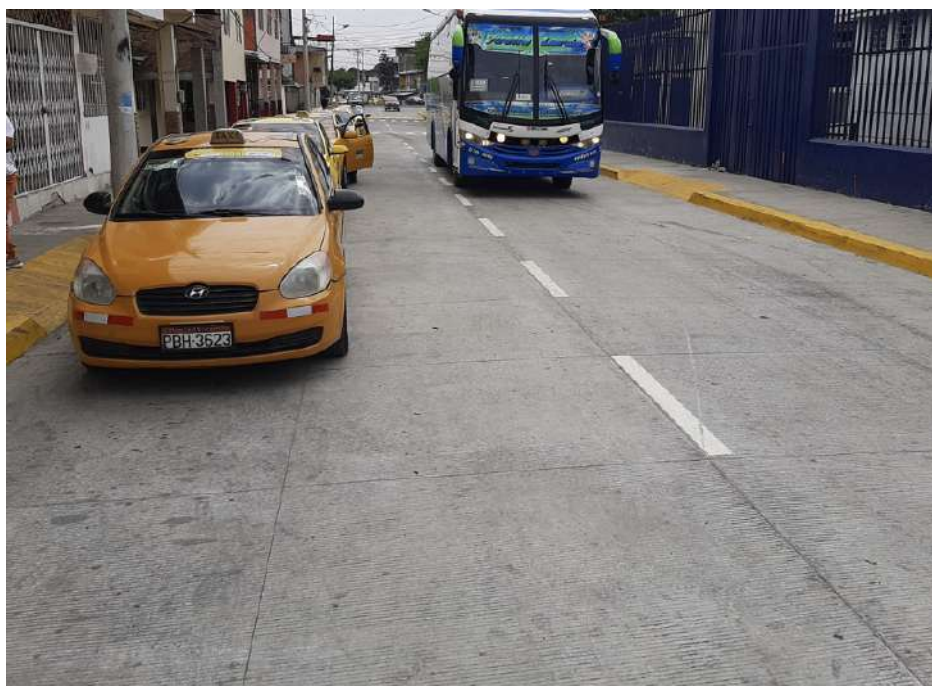
Figura 6. Portoviejo. Terminal Terrestre. Calle J. F. Kennedy y Venezuela. Pavimento TCP®. Los cortes de juntas están separados a 1,75 m de distancia aproximadamente.
