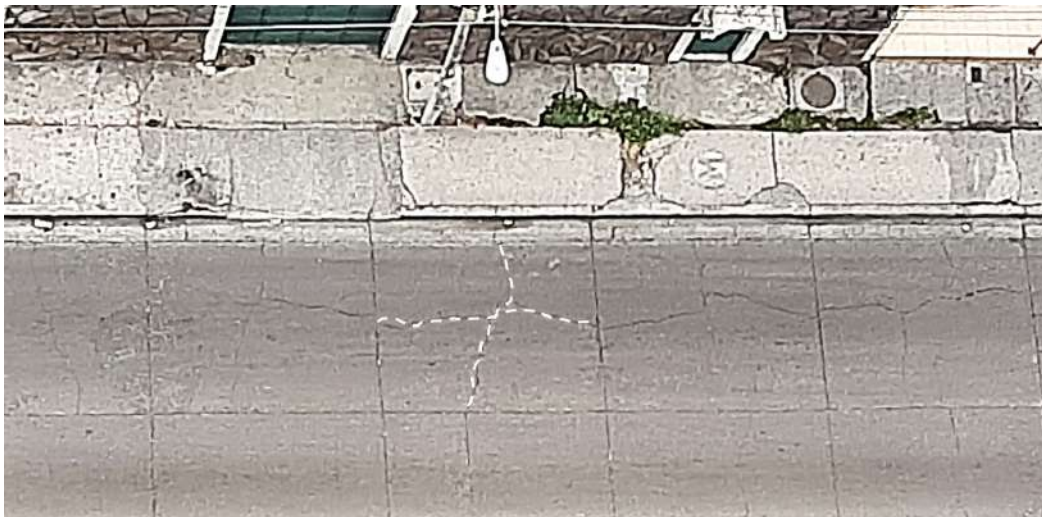
Figura 5. Pavimento rígido con 30 años de servicio con fisuras en el eje del carril y perpendiculares a este.
